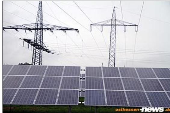
Das Problem: Riesige Stromautobahnen müssten den Strom dorthin liefern, wo er gebraucht wird.
